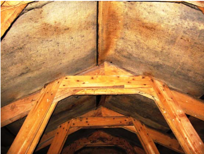
Massivt angreb af skimmelsvamp i hele tagkonstruktionen.
