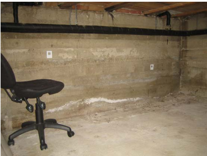
Mycometer-test taget i krybekælderen under stuegulvet.
