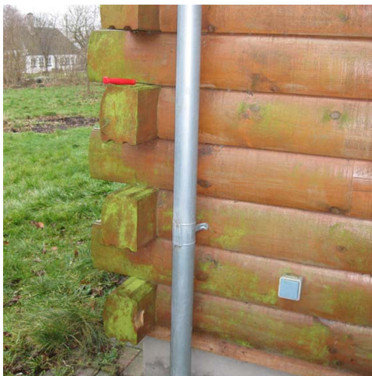
Trods kraftig algevækst var der ikke fugt og svamp i bjælkerne.
