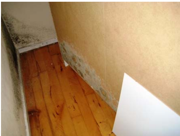
Skimmelvækst pga. vandskade fra badeværelset.
