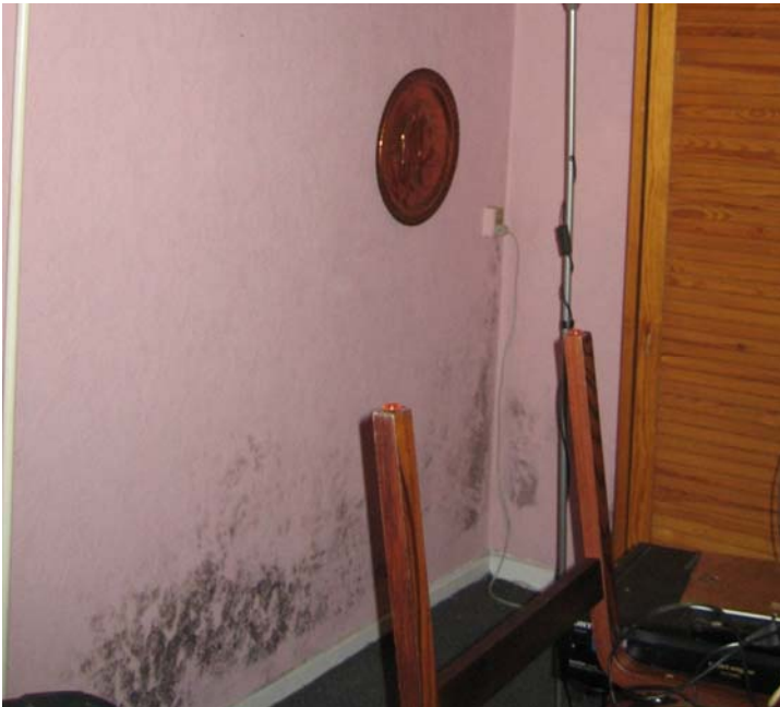
Skimmelvækst i kammeret pga. manglende isolering kombineret med for lidt opvarmning om vinteren.
