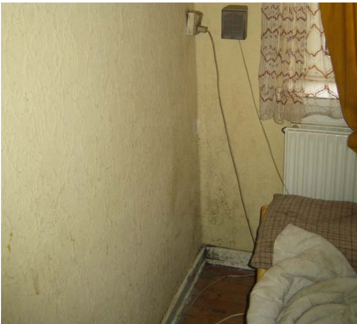
Skimmelvækst i soveværelset pga. indretningen.
